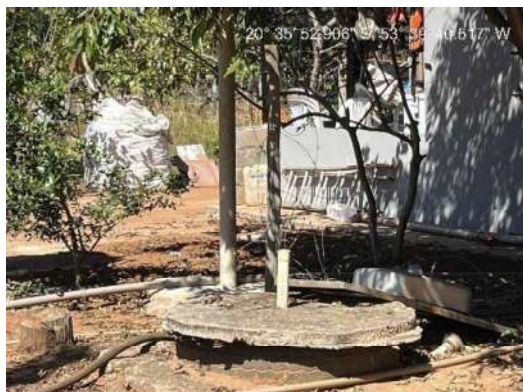
Figura 19 - Fossa séptica de um dos ranchos.
